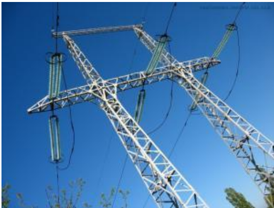
Портальна опора ЛЕП
